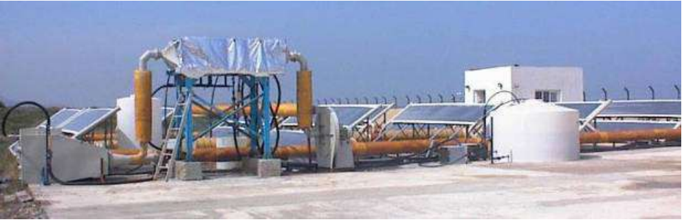
الشكل 10: محطة تحلية المياه بواسطة عملية الترطيب-إزالة الرطوبة التي تم تركيبها في المعهد الوطني للبحوث العلمية والتقنية في تونس [31]
