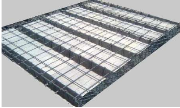
الشكل 8: صورة لبلاطة مفرغة
